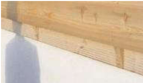
Abbildung 10: Anflughilfe mit Rillen unterhalb der Fassadenverkleidung
